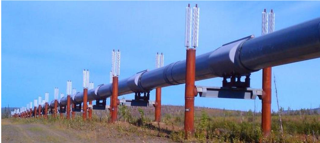
Đường ống dẫn dầu do công ty Bechtel Inc. ở San Francisco xây cất.
